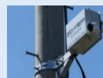
防犯カメラ設置
