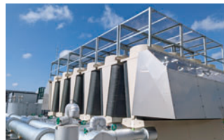
空調設備（ヒートポンプチャラー）
