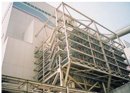
排煙脱硝装置(敦賀火力発電所)
