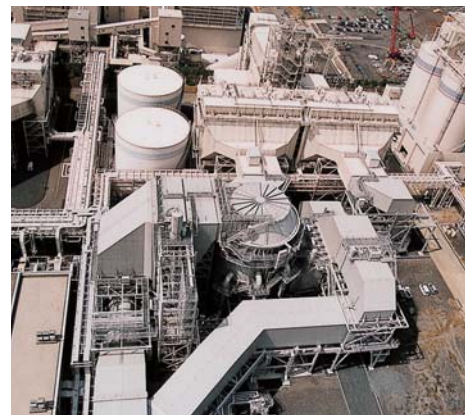
排煙脱硫装置(敦賀火力発電所)
