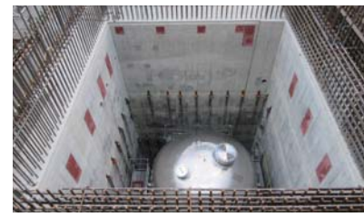
2号機フィルタ付ベント装置の据付状況 (2015年7月末現在)
