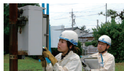
海水浴場周辺の電気設備点検
