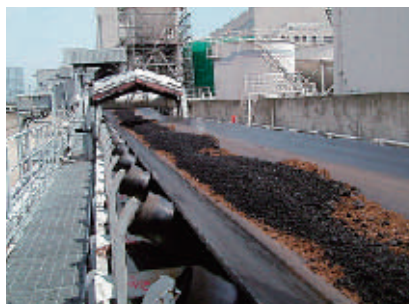
石炭運炭ベルトコン(石炭と木質バイオマス混合状況)
