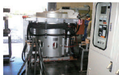
150kW溶融・無害化実証装置
