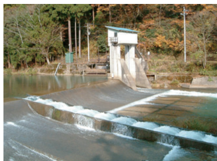
魚道設置状況（持越発電所取水ダム）
