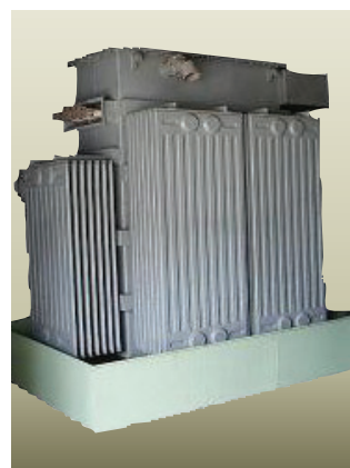
高圧トランス
