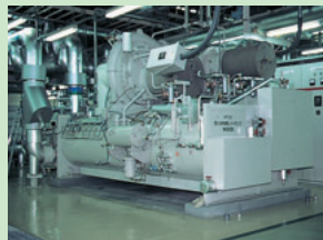
蓄熱式ヒートポンプ
